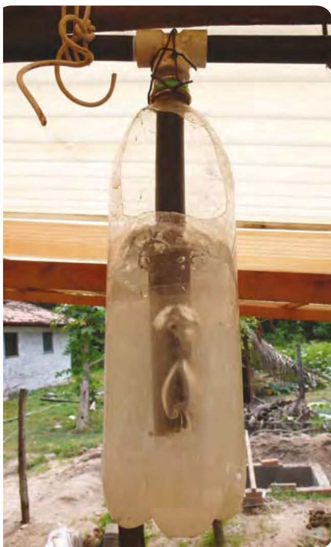
Figura 28: La válvula de seguridad se coloca al principio de la conducción de biogás, cerca del biodigestor, para poder ver todos los días si necesita más agua.
