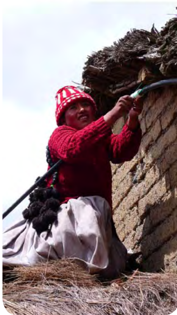
Figura 26: La conducción de biogás se hace con tubería de riego (politubo, tubería PED, tubería de pvc) de ½”, se usan los accesorios comunes, siempre con rosca.
