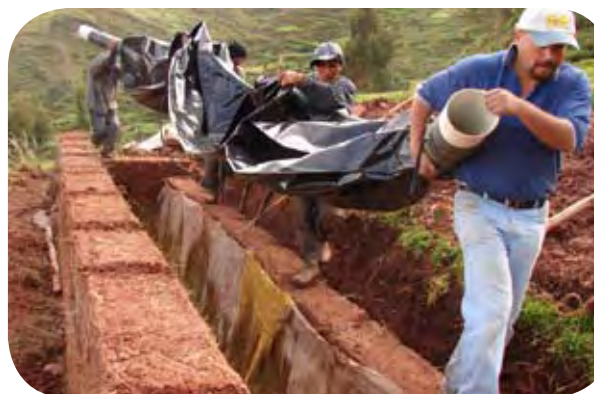
Figura 20: Una vez construido el biodigestor hay que meterlo en la zanja, con mucho cuidado de que no rocen los pliegues del plástico con ninguna pared ni piedra, ya que se podría dañar el plástico. Esta es una parte crítica en la que hay que extremar los cuidados.
