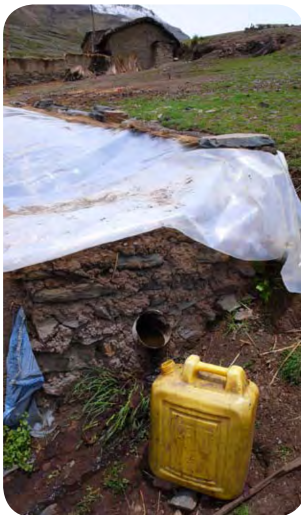
Figura 9: Salida del biodigestor por donde se derrama el biol.
