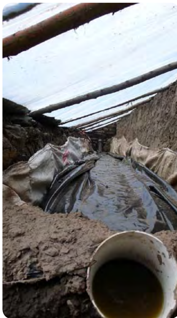
Figura 4: Biodigestor recién instalado en altiplano y en proceso de empezar a producir biogás (Pakuani, La Paz, 4200 msnm)
