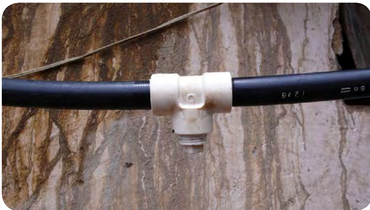
Figura 27: En los puntos bajos de la conducción de biogás se puede poner una tee con la tercera salida cerrada con una rosca. De esta manera si se acumula agua en este punto bajo, se puede purgar abriendo la rosca de la tee.
